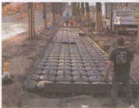
Boomontlastconstructie Den Haag.
