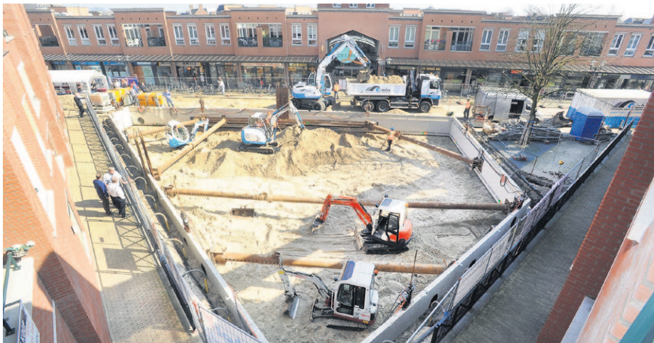
Het ontgraven van de afzinkkelder in Rijen. Foto: Erald van der Aa
